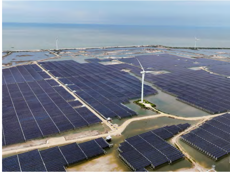
GAMBAR udara menggunakan dron yang diambil pada 8 Ogos 2025 menunjukkan sebuah projek perintis bagi integrasi fotovoltaik dan penyimpanan tenaga di Bandar Dongying, Wilayah Shandong di timur Republik Rakyat China. Bandar Dongying sejak beberapa tahun kebelakangan ini giat membangunkan tenaga bersih.
