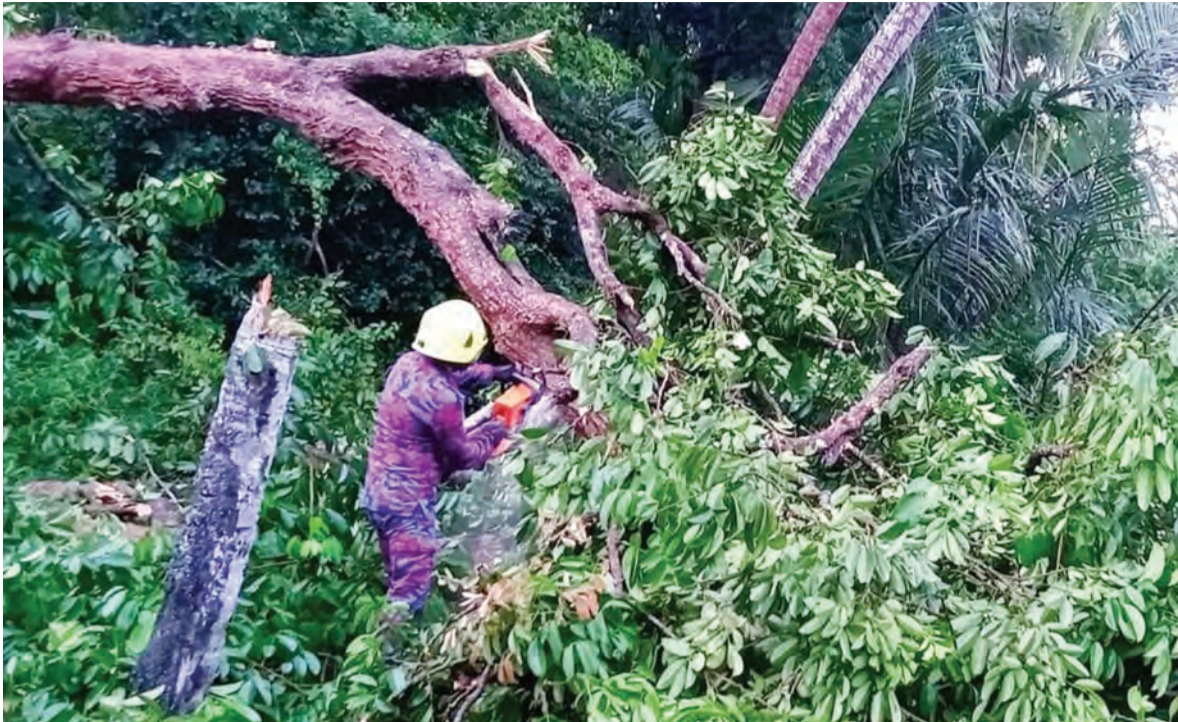
KEJADIAN pokok tumbang yang menghalangi sebahagian jalan raya, di kawasan Jalan Tarap Bau, Kampung Setia 'B'.
