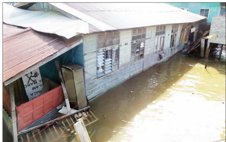
KEADAAN rumah Awang Ali bin Haji Mega yang roboh mungkin disebabkan struktur tanah yang mengakibatkan tiang yang semakin condong ke bawah dan ranap.
