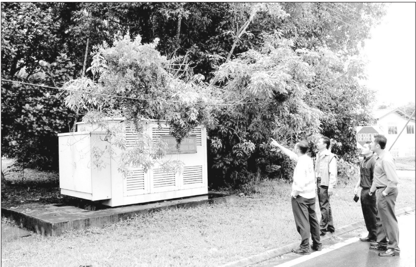
PARA pegawai dan kakitangan Unit Perhubungan Awam Jabatan Perkhidmatan Elektrik ketika membuat tinjauan dan pemantauan kejadian kabel elektrik yang terputus disebabkan sepon pohon tumbang yang berlaku di Simpang 94, Kampung Anggerek Desa. - Foto : Abdullah Haji Awang Damit.
