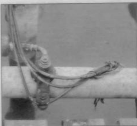
SALAH satu contoh sistem pendawaian atau penyambungan kuasa elektrik yang tidak mendapat kebenaran JPE.
