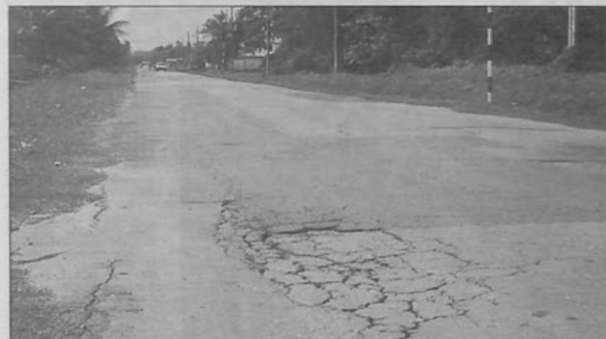
JALAN BAN 1 sebelum : Keadaan jalan raya yang telah rosak.
