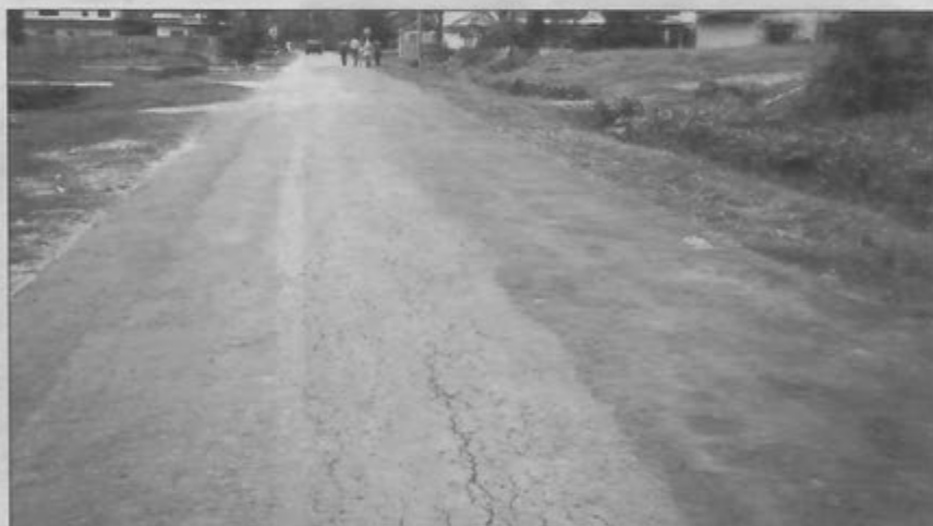
JALAN BAN 3 sebelum : Keadaan jalan raya yang telah rosak.
